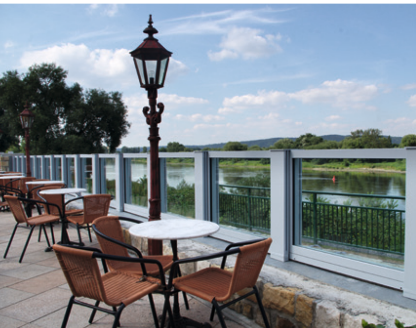
Hochwasserschutzwand mit Sicherheitsglas
