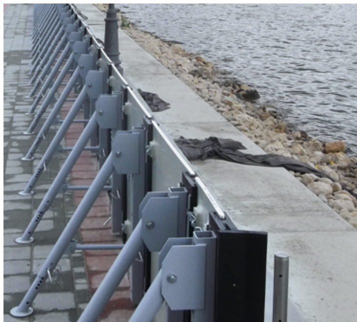
Hochwasserschutz mit Hochwasserschutzplatten aus Kunststoff
