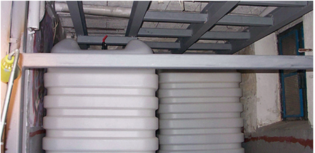
Heizöltankanlage mit Auftriebssicherung
