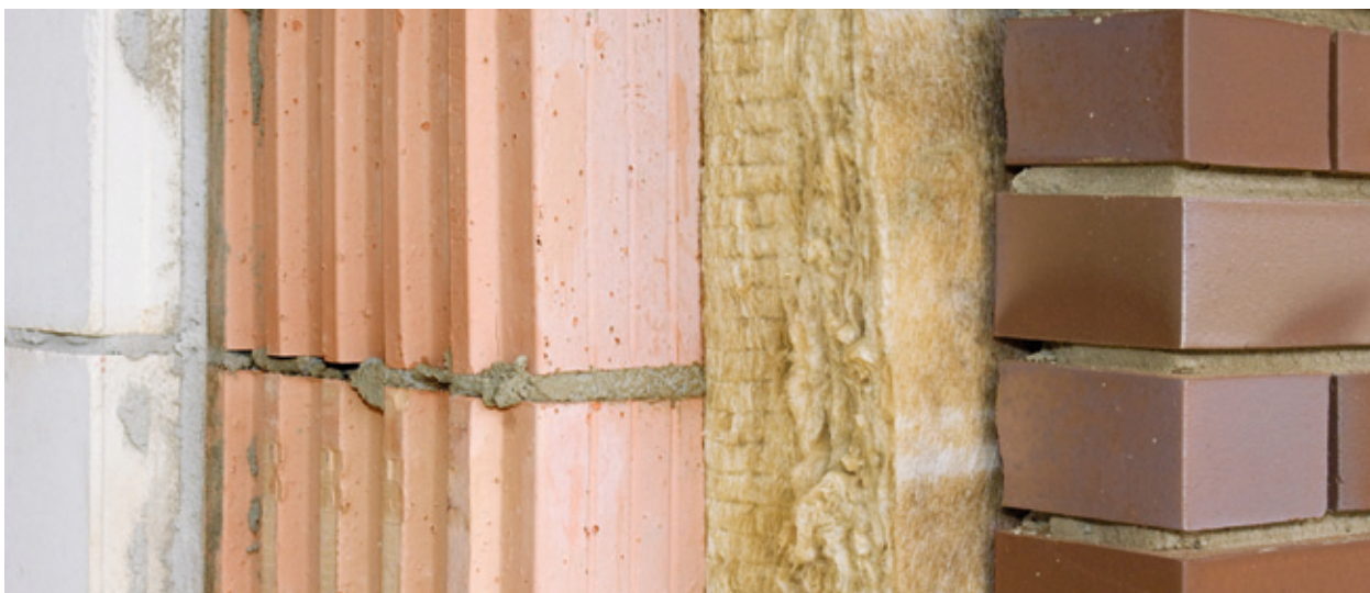
Bei mehrschaligen Außenwandkonstruktionen ist die durchfeuchtete Dämmstoffschicht nur sehr schwer zugänglich.
