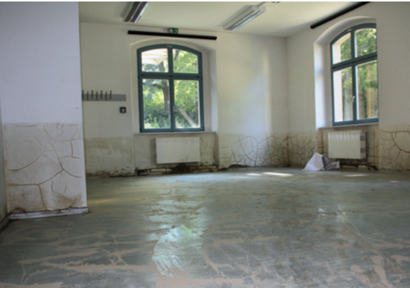
Durchfeuchtete und verschmutzte Außenwände nach Überflutung
