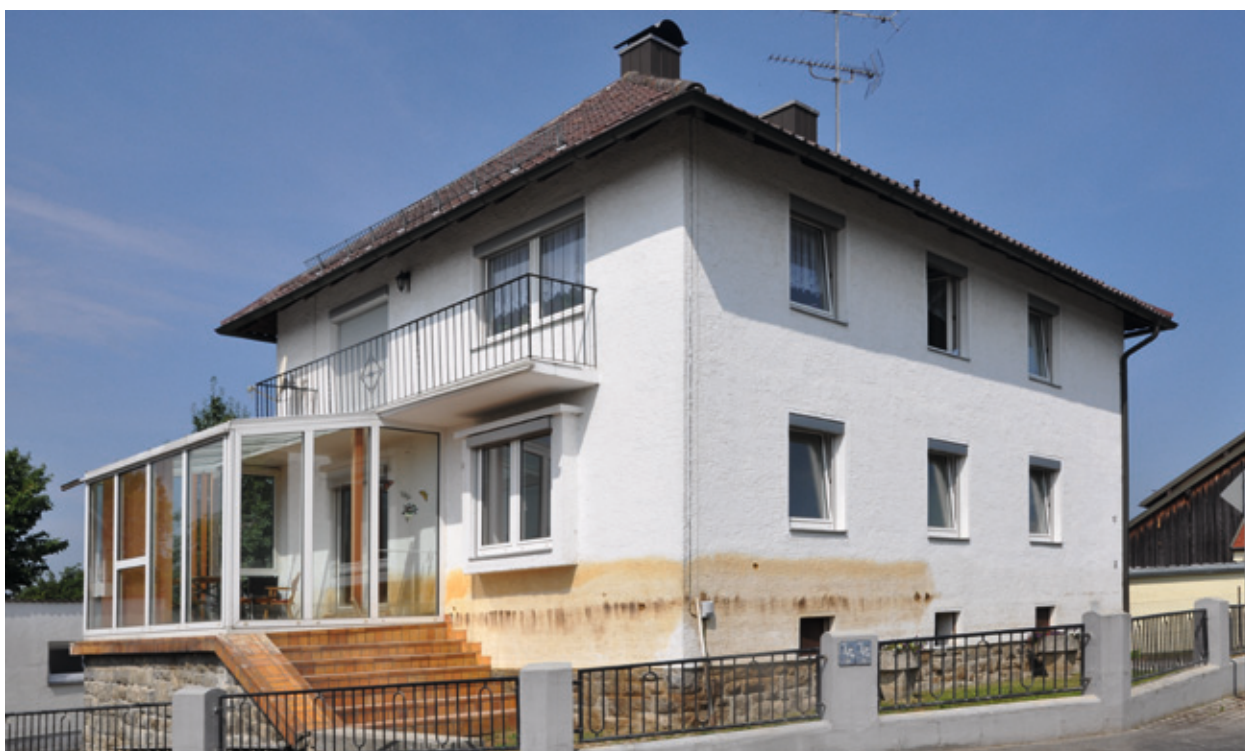
Mit Heizöl belastetes Wärmedämm-Verbundsystem eines Wohnhauses
