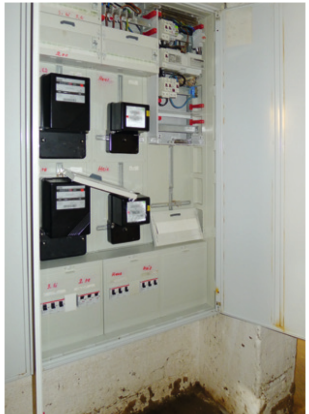
Überfluteter Sicherungsasten in einer Erdgeschosswohnung
